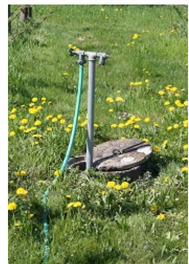
Wasseranschluss für Bewässerung direkt beim Feld
